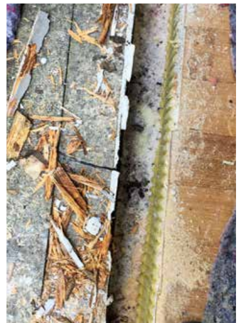
Fenstersockel mit Aushöhlung durch Ameisen.
