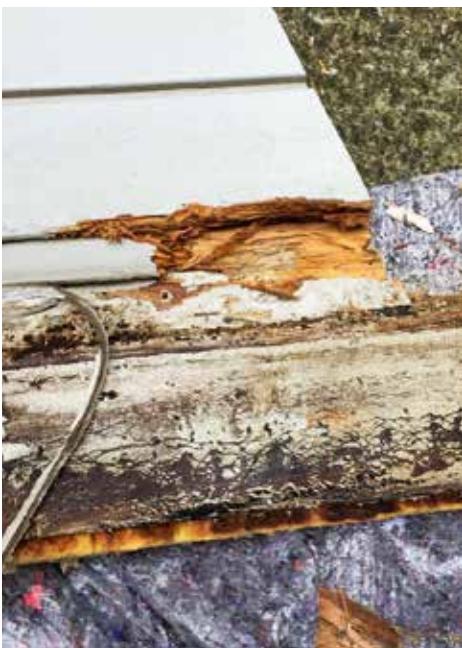
Der ausgebaute Fenstersockel zeigt deutlichen Feuchtigkeitsschaden.
