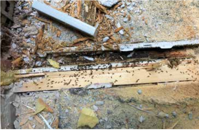
Nach Demontage des Fensters Ameisennest und Ameisenaktivität im Fenstersockel. Foto: Björn Alexander Assmus
