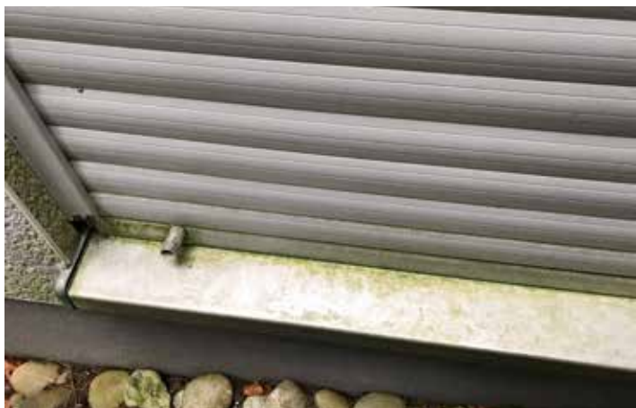
Moosbewuchs an Fensterjalousie mit Feuchteschaden an Holzführung. Foto: Björn Alexander Assmus
